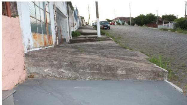
Figura 3. Calçadas com irregularidades Fonte: Autoras (2015)
